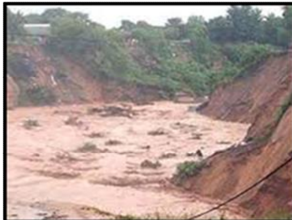
Canalización totalmente destruida.
