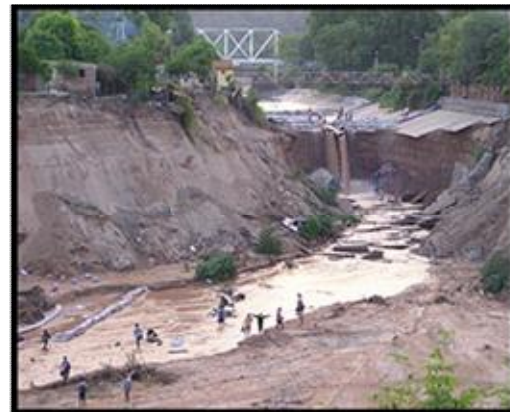
Ruptura de la canalización. Taludes de 26 metros aproximadamente.
