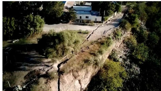
La grieta comenzó a ser vista hace un mes
