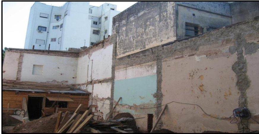
Foto 3.12.2 Pruebas de Medianería: Signos de Medianería
