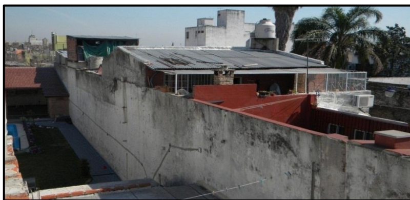
Foto 3.11.1. Muro a Reconstruir
