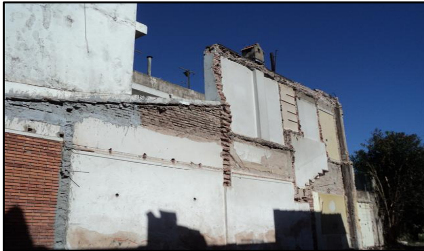
Foto 3.12.3. Pruebas de Medianería: Signos de Medianería
